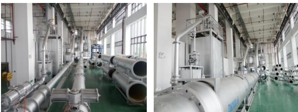
(d) DN2~DN1000 large water flow standard facility(GZIET)
